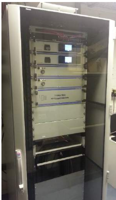
TETRA Funkschrank Technikraum
