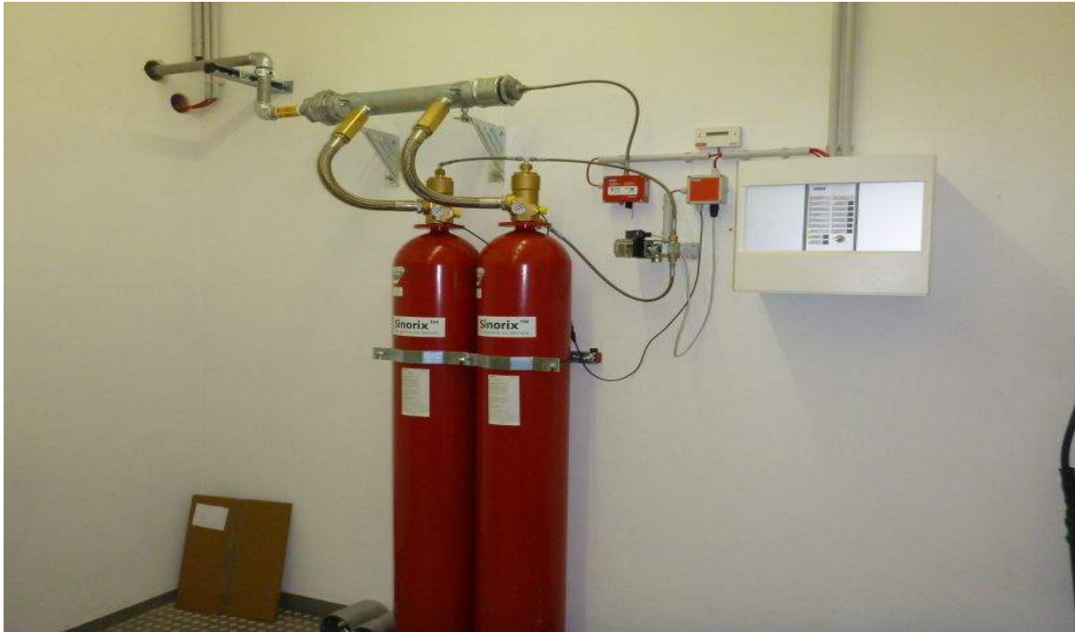
Kleine Gaslöschanlage zum Schutz eines Serverraumes
