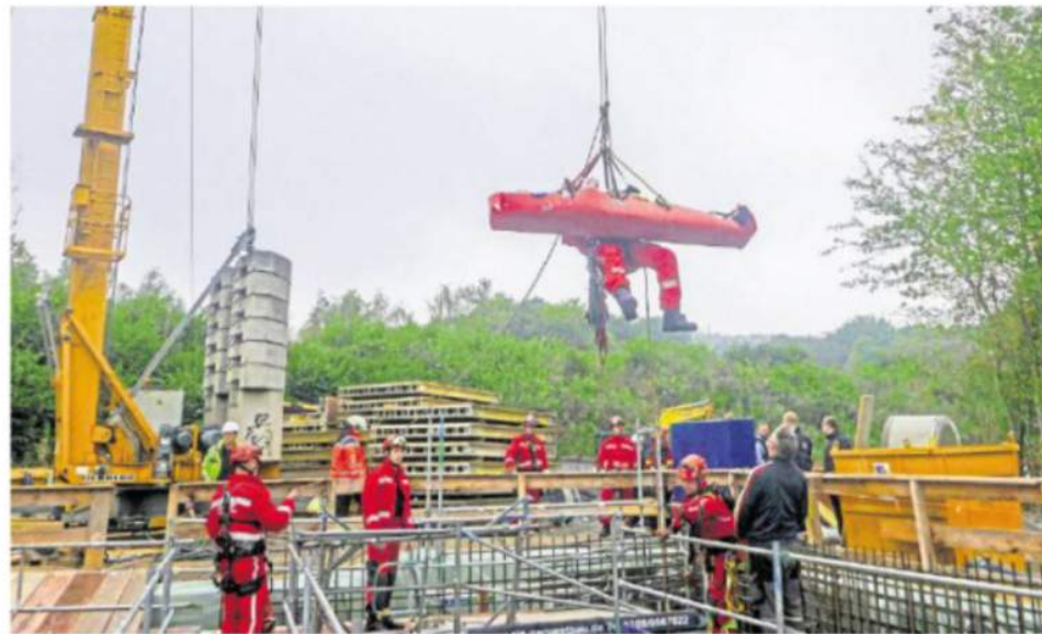
Oben am Ausleger des Baukrans befestigt, seilt sich ein Höhenretter in den 16 Meter tiefen Schacht hinab und holt den schwer verletzten Arbeiter nach oben. –FOTO: HA
