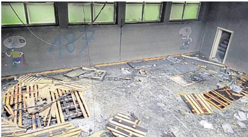
Durch ein Oberlicht am höher liegenden Haupteingang der Sporthalle ist dieses Foto entstanden. Mit Motorsägen haben die Einsatzkräfte den Boden aufgeschnitten, um Glutnester zu löschen. Alles ist voller Ruß. —FOTOS: FRANK BERGMANNSHOFF
