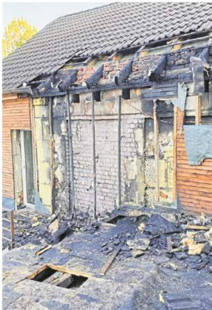
Die vom Feuer zerstörte Fassade des Anbaus.
