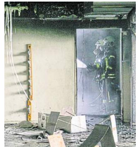
Feuerwehrlaute löschen in der Sporthalle. Auch in den Nebenräumen sind die Schäden durch Ruß und Hitze groß.
